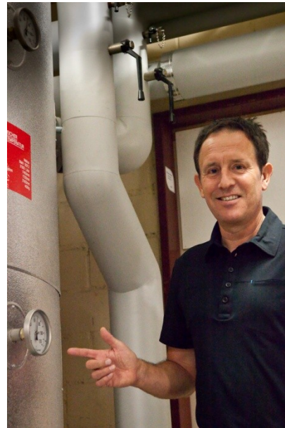
Fredy Rhein von ETU-Engineering freut sich über die 70°C Abwärme im Speicher.
