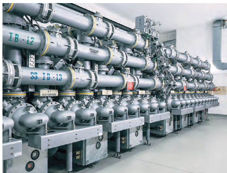
Eine Hochspannungsschaltanlage ist ein zentraler Teil unserer Infrastruktur. Sie sorgt dafür, dass Strom sicher geschaltet und zuverlässig verteilt werden kann.
