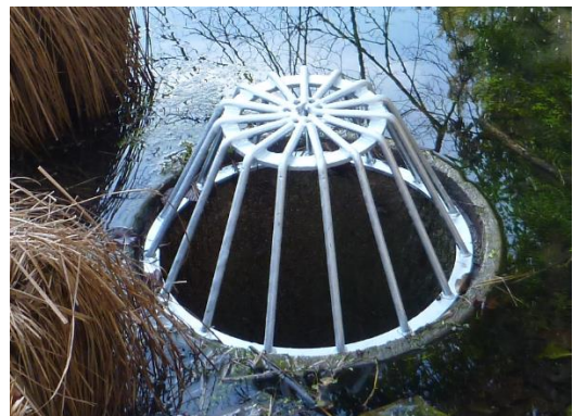
Abbildung 11: Beispiel eines Notüberlaufs in Winterthur, wenig anfällig für Verklausung (Quelle: HOLINGER AG)
