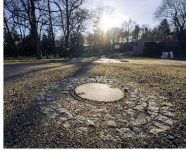
Abbildung 80: Zisterne unter dem Friedhof Georgen-Parochial II gespeisen durch privates Dachwasser von privater Liegenschaft, Berlin DE (Quelle: Berliner Regenwasseragentur)
