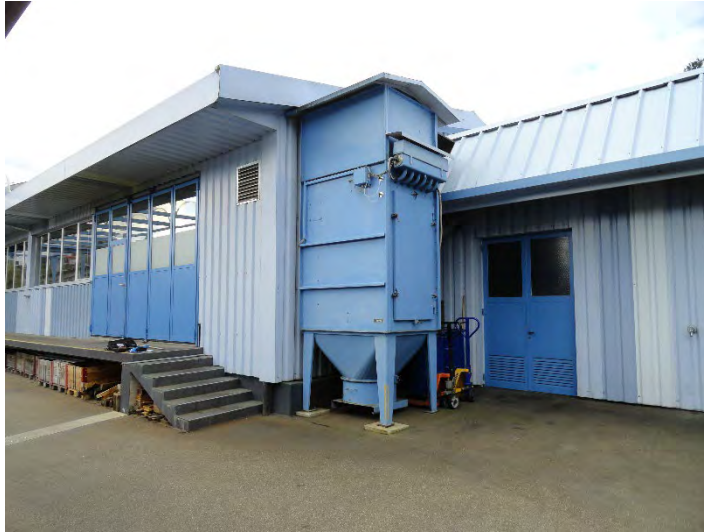
Abb. 19 Filteranlage Jost AG (planteam 21.10.2016)
