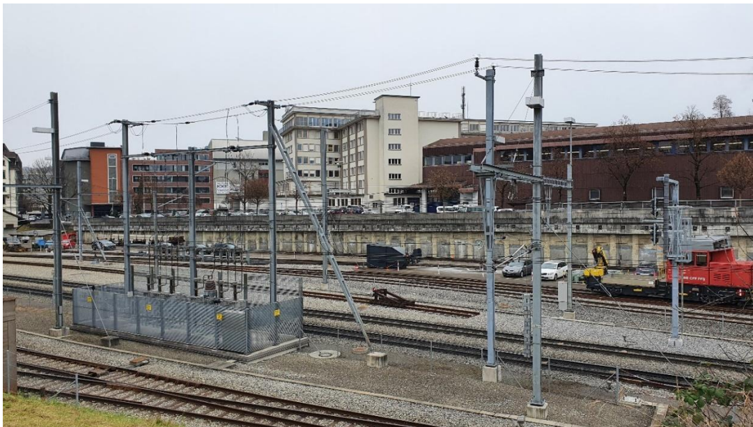
Abbildung 7 Fahr- und Elektroleitungen inkl. Einspeisepunkt für Fahrstrom
