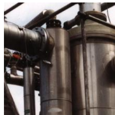
Abwärmenutzung und Wärmerückgewinnung
